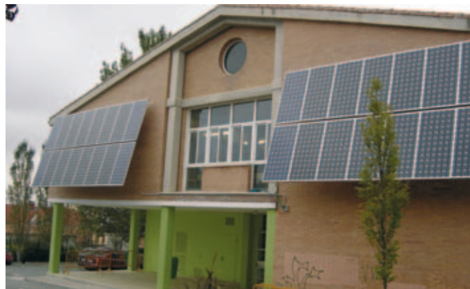
Placas solares instaladas en un colegio.
